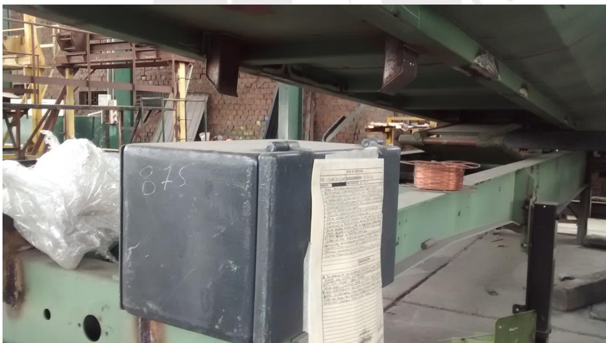
Figura G2. Error en colocación de accesorio por modificación plano de instalación de accesorios.
