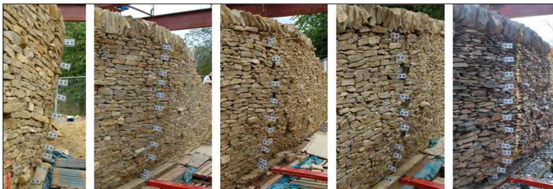
Figura 5. Muros de piedra de junta seca que han fallado por toppling (McCombie, P. F., Mundell, C., Heath, A., & Walker, P., 2012)
