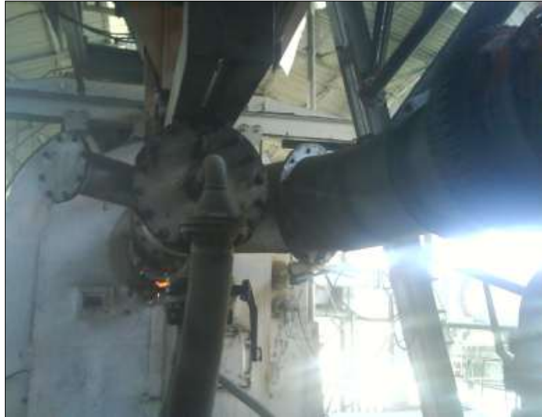
Figura 16. Entradas de gas natural y de la mezcla aire-carbón al quemador.
