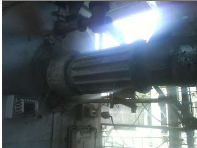
Figura 14. Montaje del quemador en el horno.
