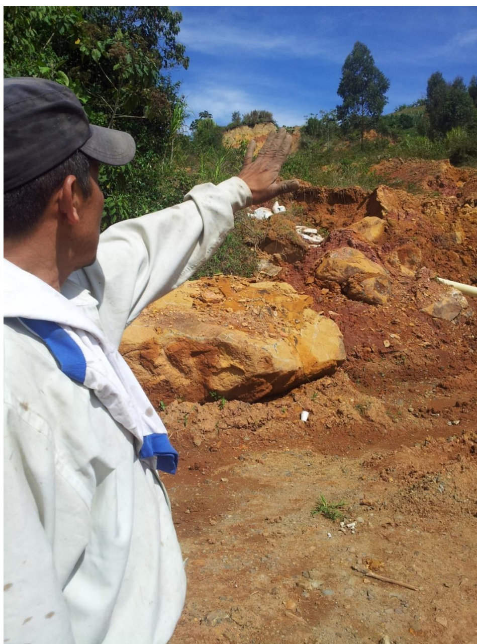
Movimiento de remoción en masa en Villa Nueva.
