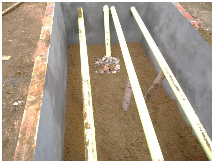
Ilustración 2. Vista interior de las paredes, piso y tuberías de distribución (FENAVI, 2019)
