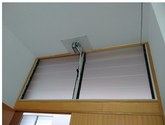
Figura 4.4: Banderias reguláveis do sistema de renovação de ar da TR2.
