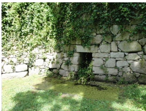
Figura 4.16 Condições do Tanque 1.
