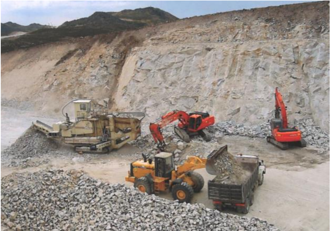
Figura 12 - Atividades de desmonte, britagem no local e transporte de agregados num troço da obra de construção da A24. (Para lá dos montes – A construção da A24, 2007).
