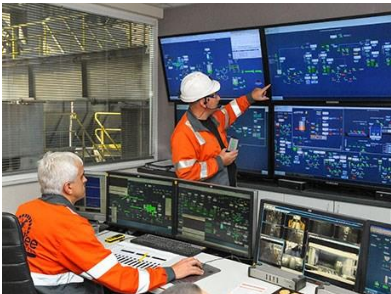
Figura 20 - Exemplo de uma sala de controlo de uma unidade extrativa e de produção de concentrados de espécies minerais. Imagem da Internet. Acedido em junho de 2020 em: http://www.xinhaimineral.com/en/solution_18.html
