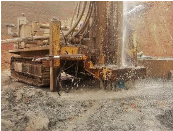
Figura 48 – Máquina perfuradora utilizada na execução do furo de pesquisa de água (fonte própria).
