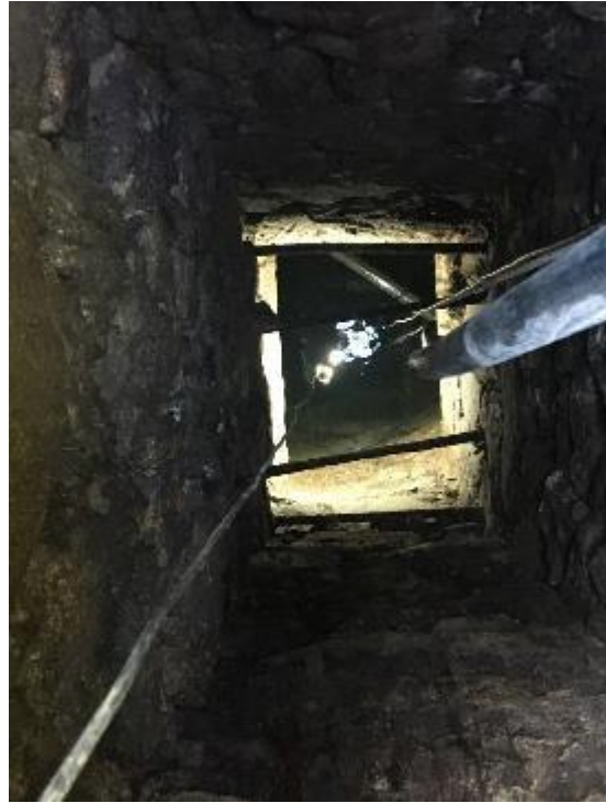
Figura 69 – Interior do poço de captação (fonte: própria).
