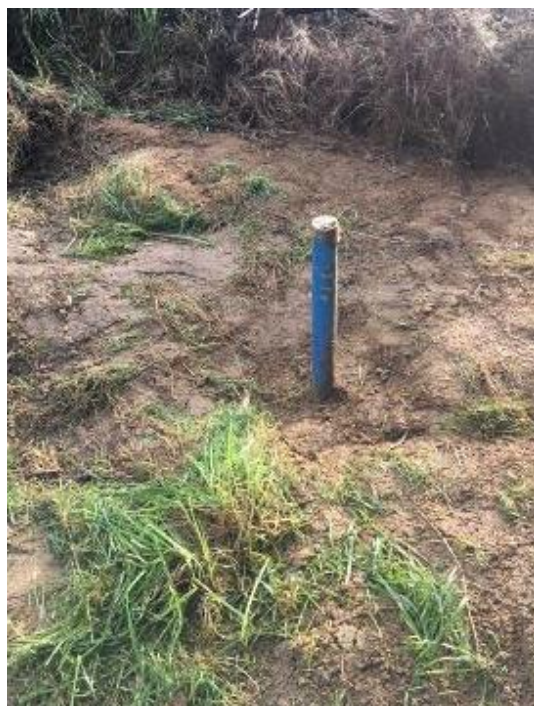
Figura 65 – Tubo piezométrico já instalado. Ainda por realizar corte do tubo de acordo com a topografia e execução da tampa de selagem (fonte: própria).
