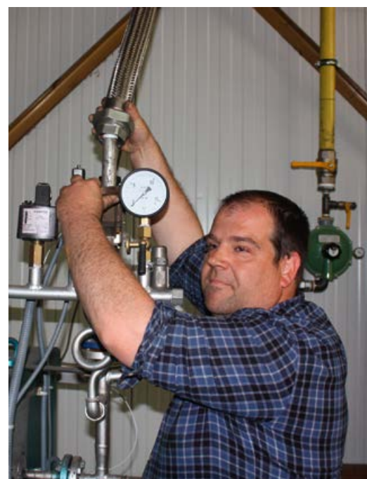
Industrieel ingenieur Hans Moerenhout: "Met onze stoomgeneratoren kunnen we er zorgen voor een energieverbruik dat tot 30% lager ligt dan dit van traditionele vlampijpketels." (Foto: KM)
