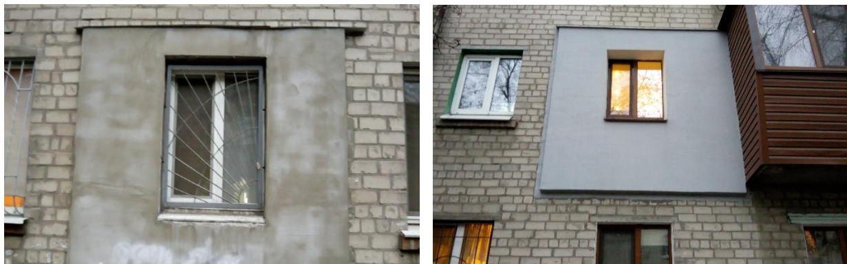
Рис. 1. Вигляд фрагментарних утеплювачів товщиною 5 см (ліворуч) та 10 см (праворуч) на цегляній стіні будинку
