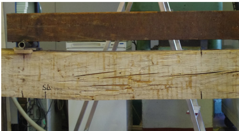
Slika 54: Stropnik 4 po upogibnem preizkusu, kjer je prišlo do porušitve v natezni coni prereza (mesto porušitve približno na sredini razpona)
