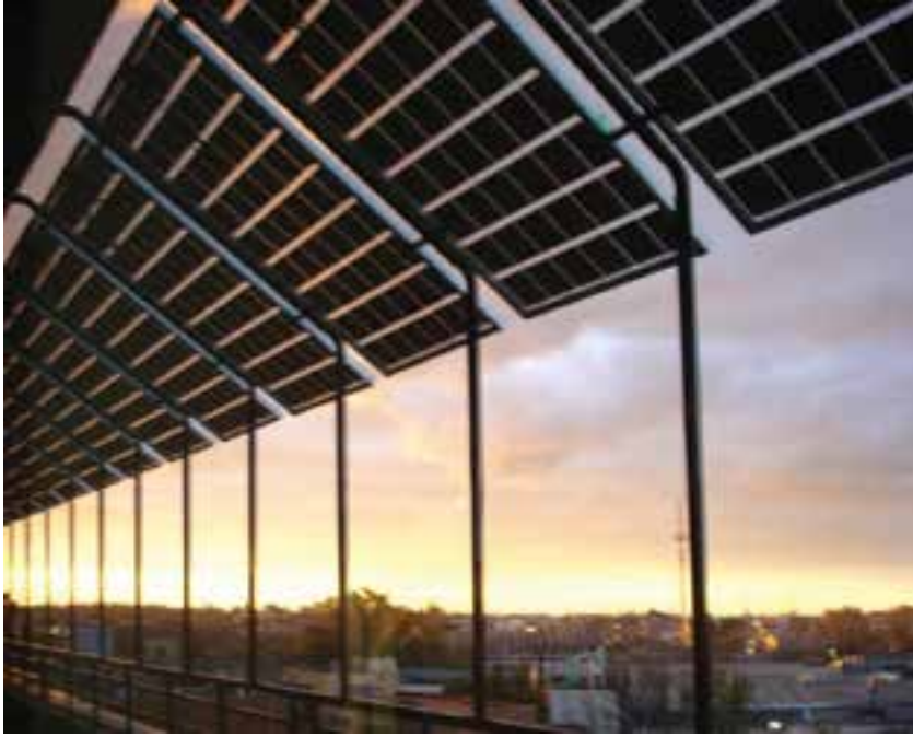
Paneles fotovoltaicos instalados en forma de alero en un edificio del Centro Atómico Constituyentes, de la CNEA.
