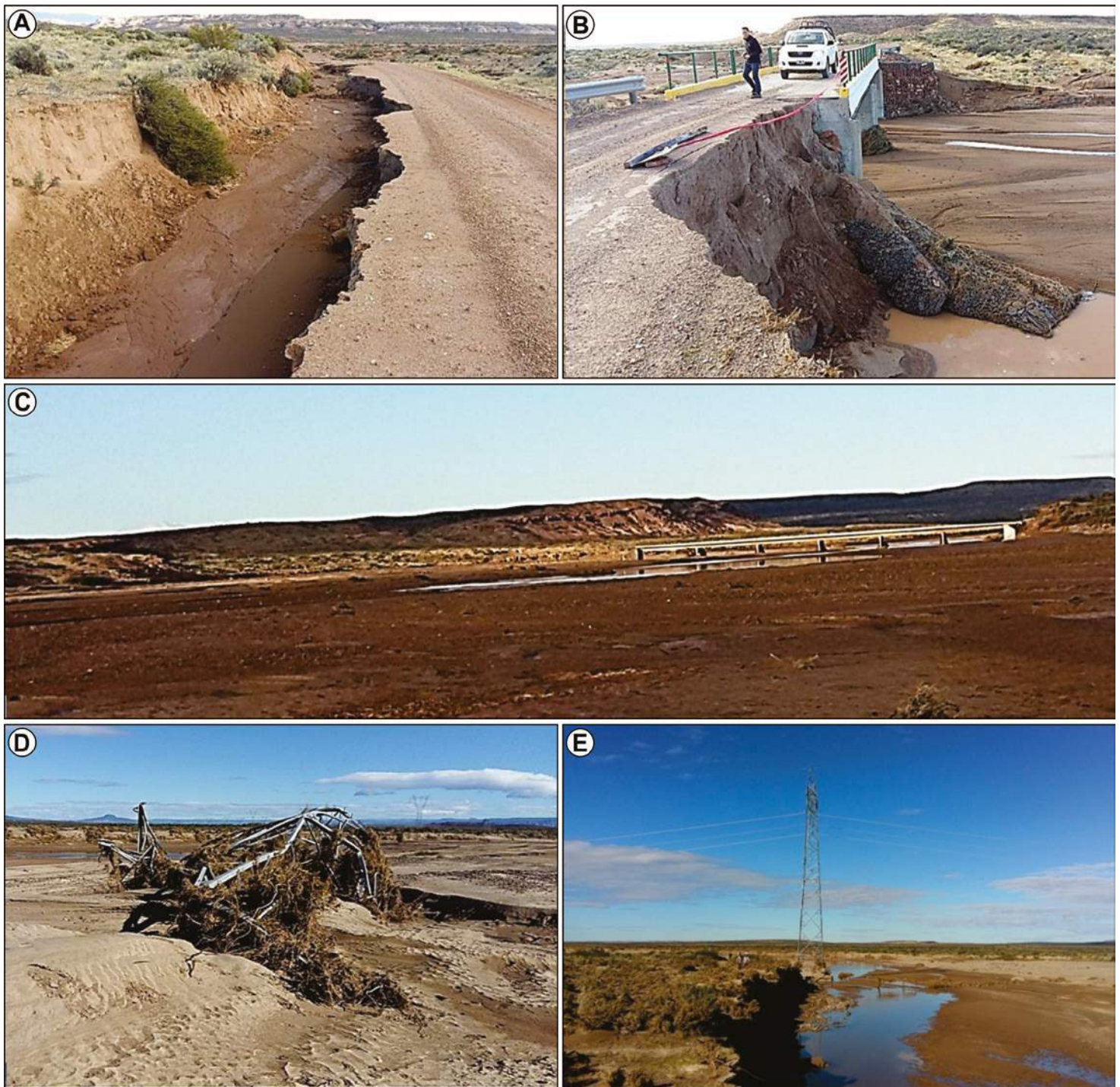
Figura 13. (A) Desarrollo de erosión con formación de cárcava en la banquina de la Ruta Prov. N° 59, (B) erosión del terraplén de aproximación de margen izquierda del puente de la Ruta Prov. N° 59 sobre el Arroyo Ponte, (C) vista desde aguas abajo del puente de la R.P. N° 59 sobre el Arroyo Perdido, (D) Torre 887/N de la línea de alta tensión Futaleufú-Aluar que fue derribada por la corriente y arrastrada 500 metros, (E) vista desde aguas arriba de la torre 885/S con importante erosión de la fundación.
