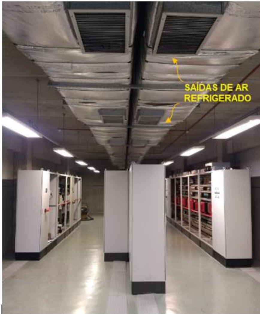
Figura 6 - Sistema de refrigeração dutado utilizado em sala elétrica da Duratex.
