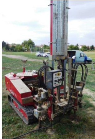
Fig. 3.2. Pou d'injecció per a dur a terme les proves pilot (Font: [16])
