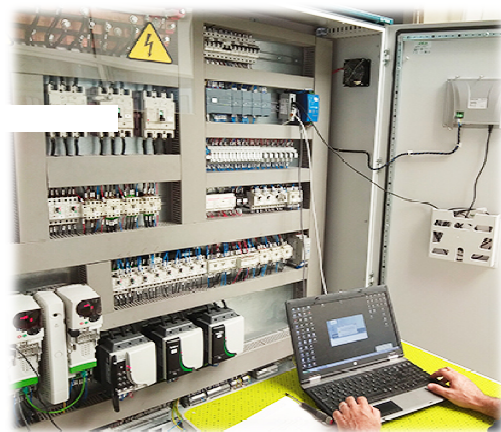
Figura 10: PLC controlat per un PC
