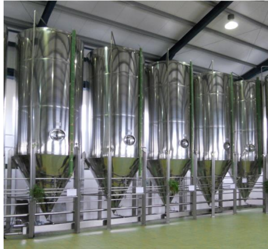
Figura 22. Tanques de almacenamiento de AOVE Treico
