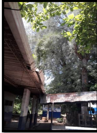
FIGURA 46. ESTADO ACTUAL DE CANALES DE AGUA LLUVIA, BLOQUE #4.
