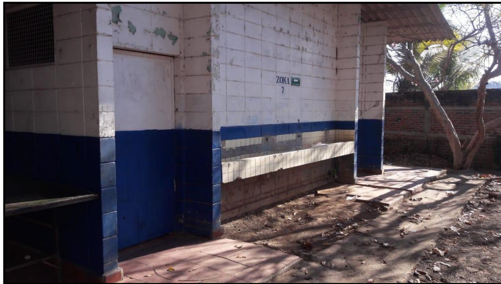
FIGURA 131. LAVAMANOS Y PISO EN BLOQUE #4 DAÑADOS, ÁREA DONDE SE REALIZARÁ PROPUESTA DE ANTEPROYECTO.
