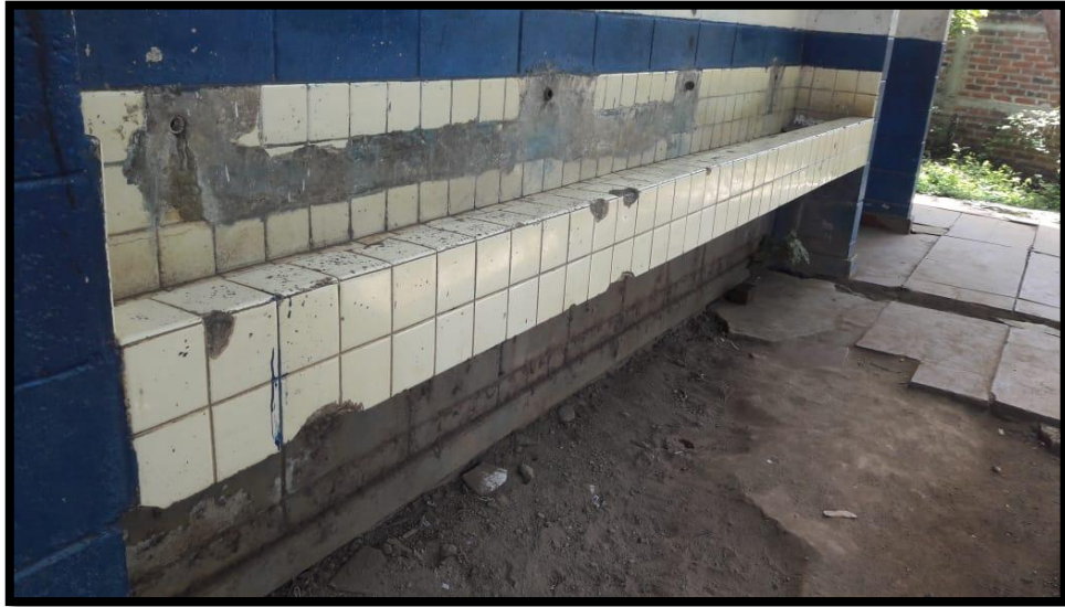
FIGURA 49. PISO Y LAVAMANOS DETERIORADO, BLOQUE #4.
