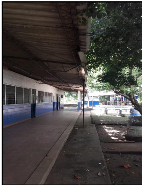
FIGURA 130. PASILLO PRINCIPAL DE BLOQUE #4 EN MAL ESTADO, ÁREA DONDE SE REALIZARÁ PROPUESTA DE ANTEPROYECTO.
