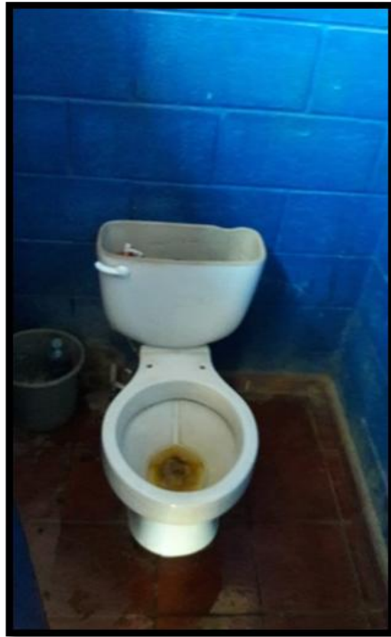
FIGURA 64. INODOROS DAÑADOS EN BAÑOS DE CABALLEROS.
