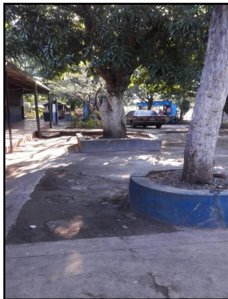
FIGURA 126. ESTADO ACTUAL DE PISO Y ARRIATES FRENTE A BLOQUE #1.
