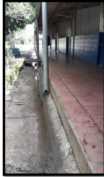
FIGURA 38. CUNETAS EN MAL ESTADO, BLOQUE #1.
