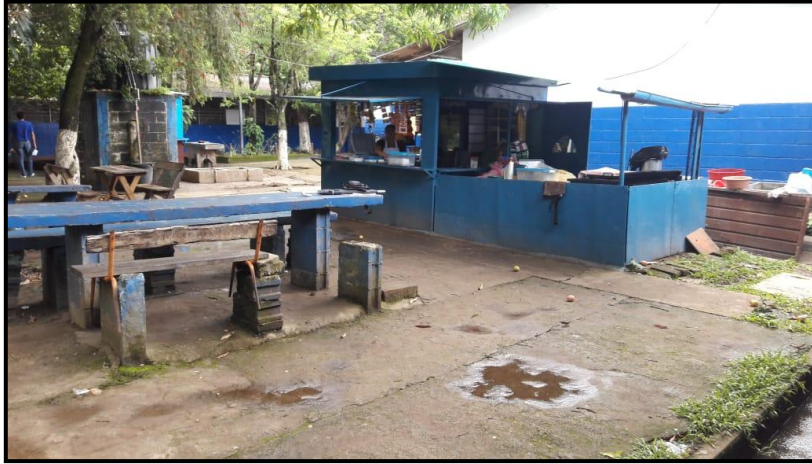
FIGURA 111. ÁREA DE CAFETÍN Y BANCAS EN MALAS CONDICIONES.
