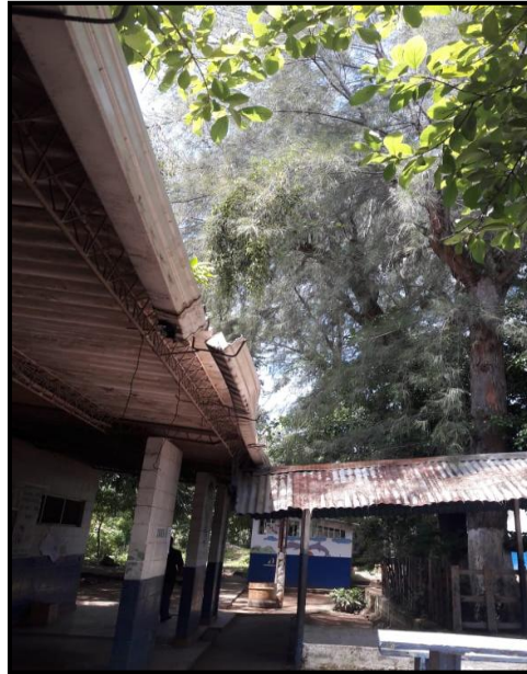
FIGURA 129. CANAL DE RECOLECCIÓN DE AGUA LLUVIA DE BLOQUE #4 DAÑADO, ÁREA DONDE SE REALIZARÁ PROPUESTA DE ANTEPROYECTO.
