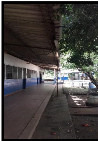
FIGURA 48. LAVAMANOS DAÑADOS Y PISO EN MAL ESTADO, BLOQUE #4.
