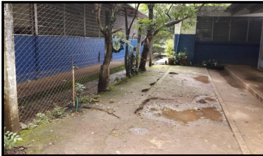
FIGURA 58. PISO DAÑADO FRENTE A AULAS DE PARVULARIA.
