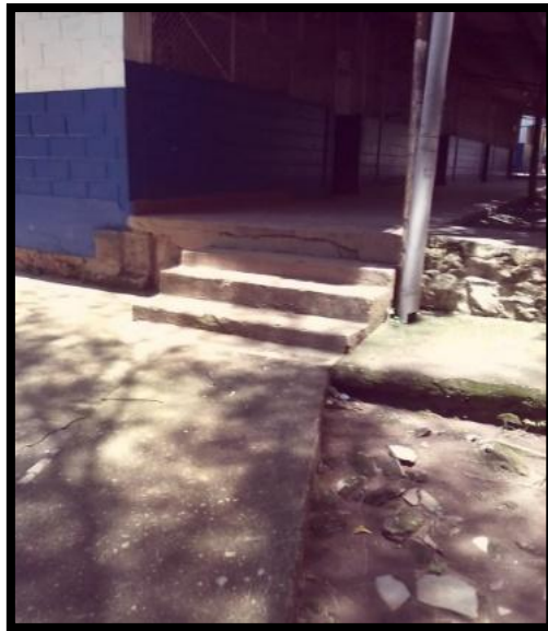
FIGURA 52. GRADAS Y PISO EN MAL ESTADO, BLOQUE #5.
