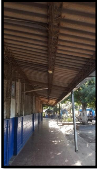
FIGURA 39. MAL ESTADO DE ALUMBRADO, BLOQUE #1.
