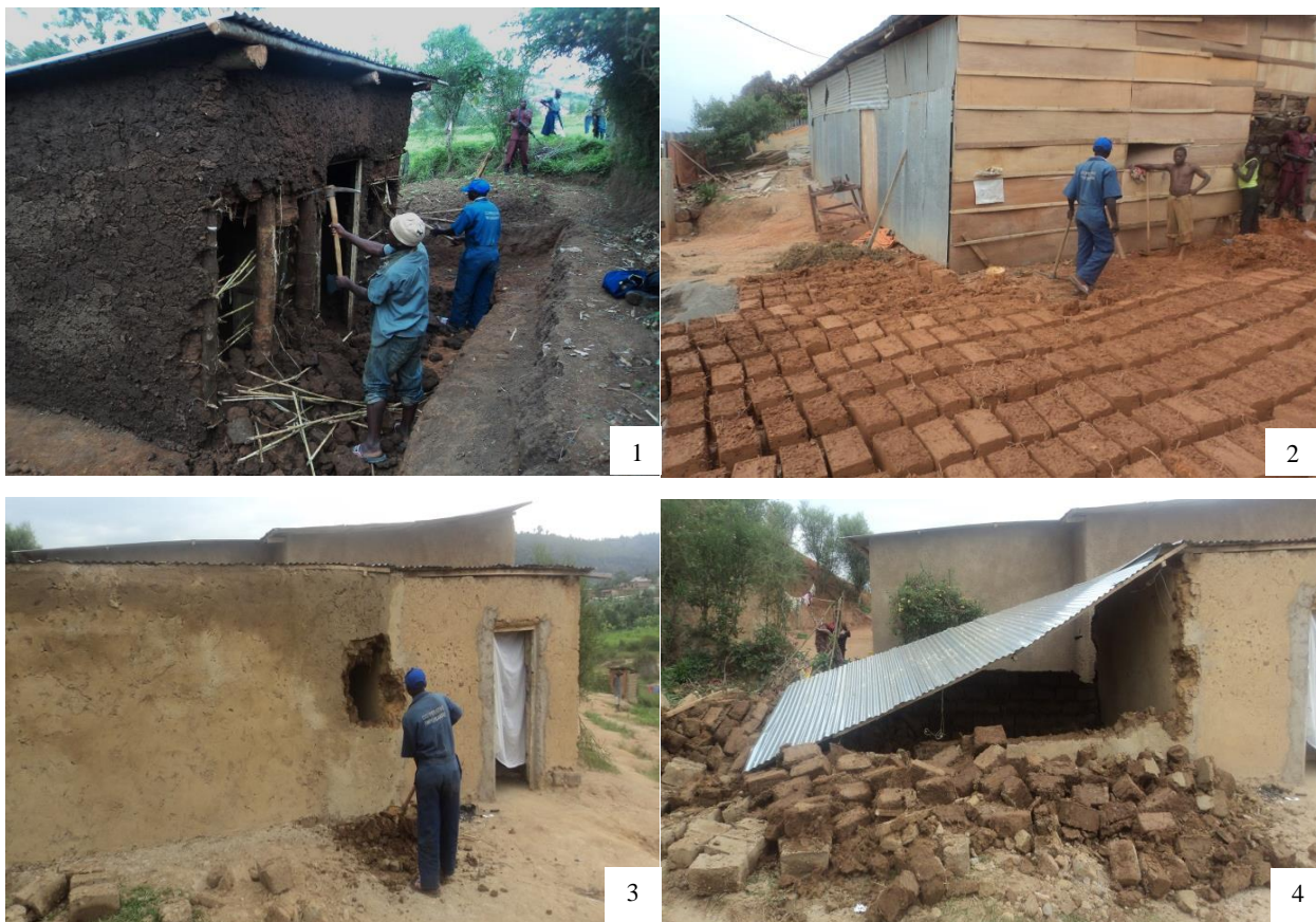
Figure 38 : Situation de construction et de destruction des maisons irrégulières
