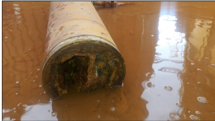
Figura 18 Obstrucción en la tubería de descarga.
