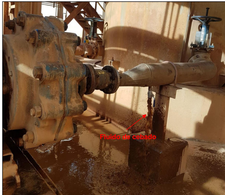
Figura 17 Falta de cebado en la bomba.
