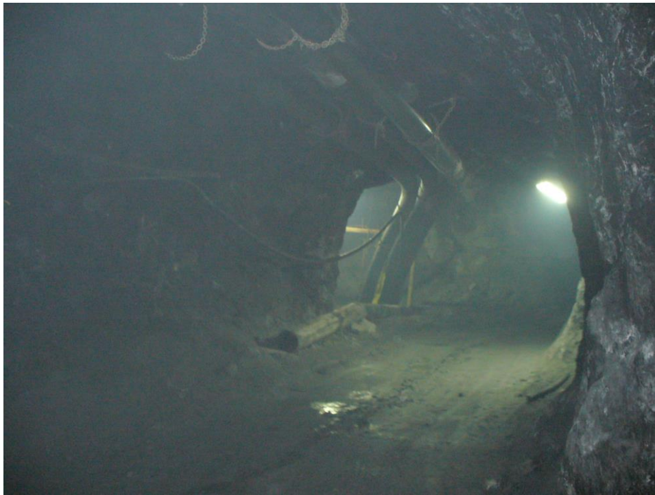
Foto N° 12, Tubería de polietileno usado en bombeo, en la mina SIMSA (Perú).
