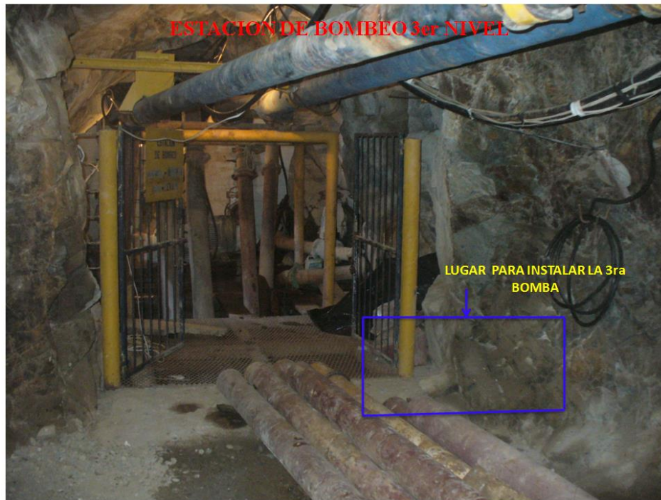
Foto N° 9, Estación de bombeo del 3er Nivel.
