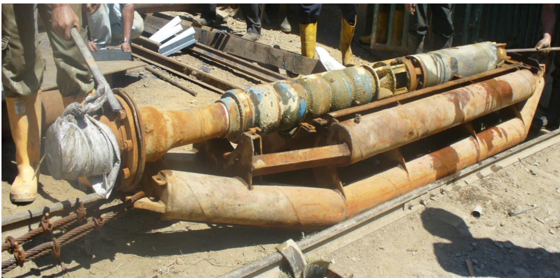
Foto N° 7, Bomba sumergible de 75Hp con su protección.
