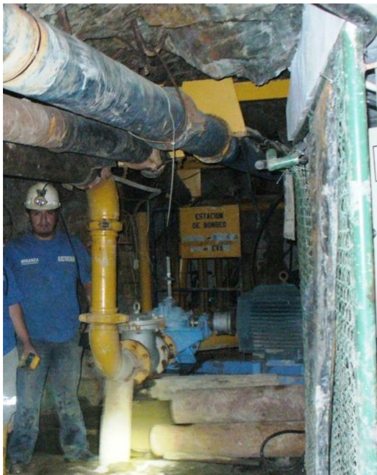
Foto N° 15, 3ª Bomba Estacionaria en Operación en el 3er Nivel.
