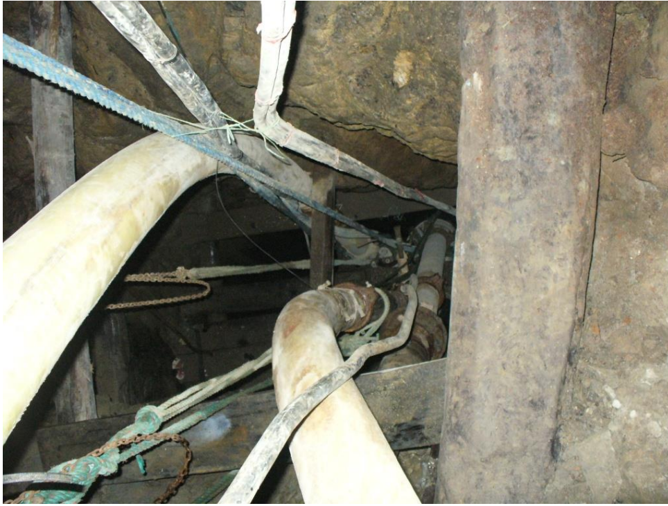
Foto N° 13, Bombas S. Flygt Instaladas a 4 metros por debajo del 5º Nivel.
