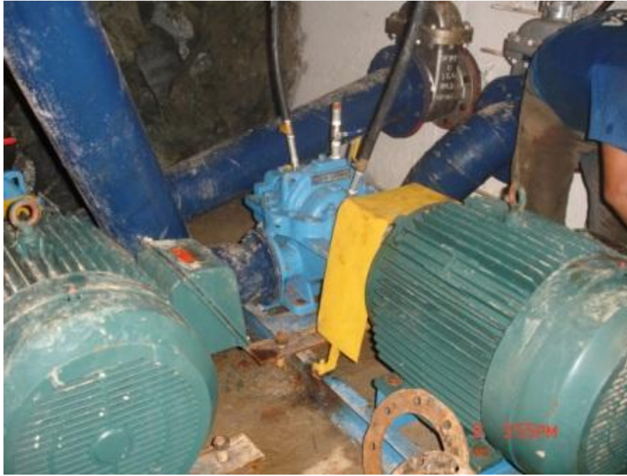
Foto N° 8, bombas estacionarias del 3 er Nivel.
