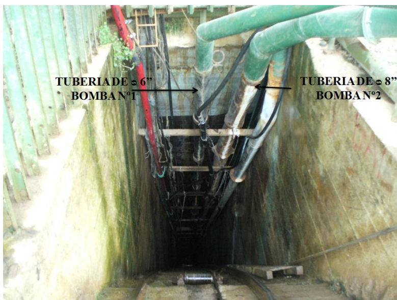
Foto N° 10, Tuberías de Descarga de las 02 Bombas Estacionarias. (Entrada del Pique Inclinado- MINESADCO)
