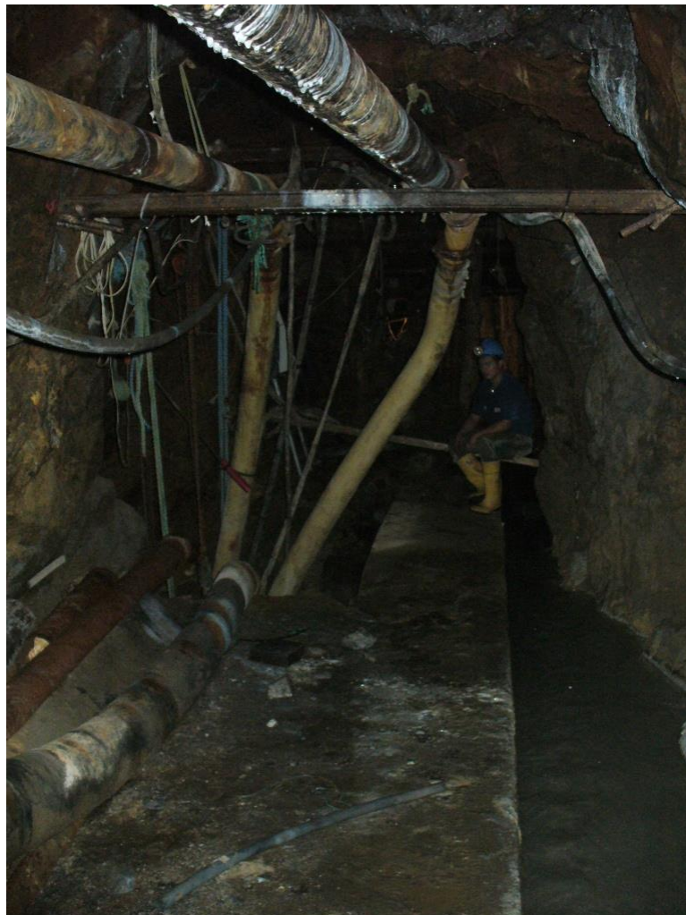
Foto N° 14, Ubicación de las Bombas Sumergibles en el 5º Nivel.
