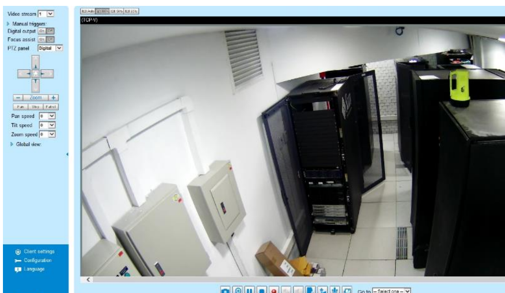
Figura 25. Video Vigilancia – Parte1 . Fuente. Elaboración propia basada en el aplicativo del Data Center del Ministerio de Vivienda, Construcción y Saneamiento-COFOPRI.
