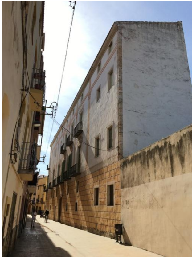
Fig. 33. Façana del carrer de les Premses on s'aprecia la diferència entre la composició original i l'afegit.
