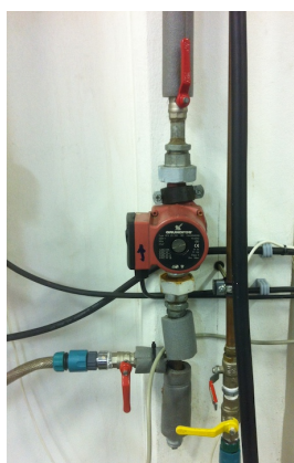
Slika 27. Cirkulacijska pumpa primarnog rashladnog kruga
