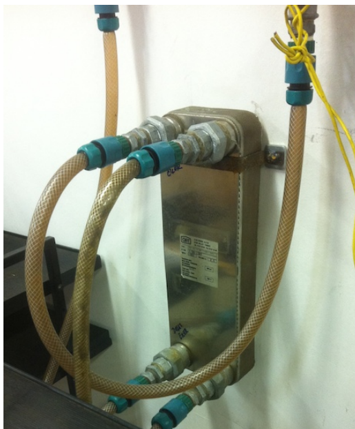
Slika 25. Pločasti izmjenjivač rashladnog kruga
