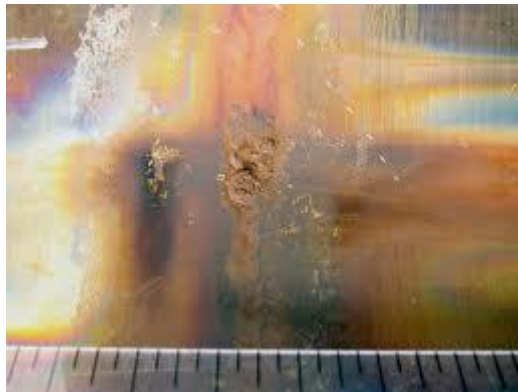
Slika 17. Rupičasta korozija na posudi bojlera [24]
