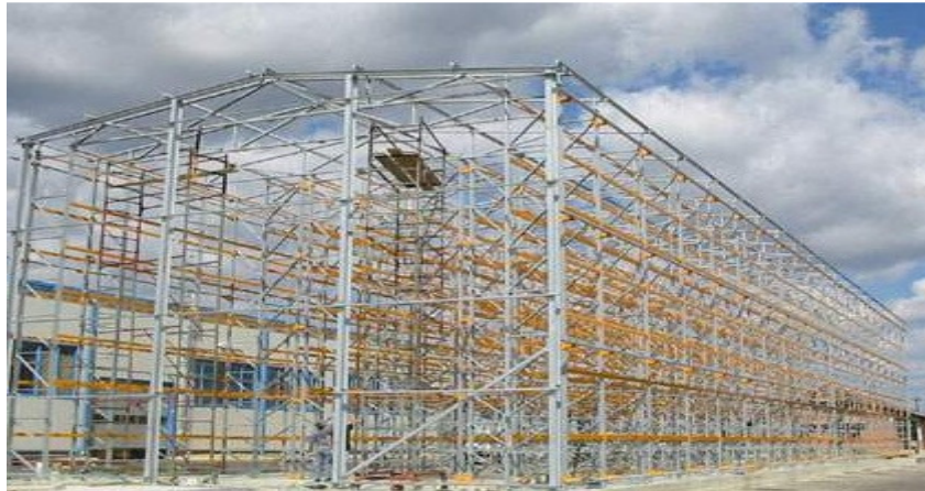
Slika 23. Samonosivo regalno skladište
