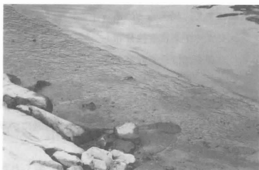
図58 ヘドロの堆積した河川底（相生橋付近）
