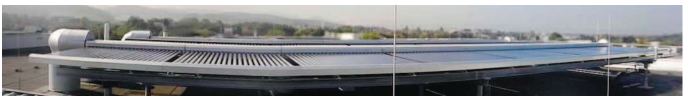
Abb. 3.2-5: Vakuümrohrluftkollektorfeld der STAR1-Pilotanlage in Freiburg. Kollektoren des Typs Sun-Storm der Kollektorfabrik GmbH & Co. KG. Die Kollektoren sind horizontal (0°) auf dem Dach ausgerichtet. Die außenliegenden Luftkanäle sind isoliert
