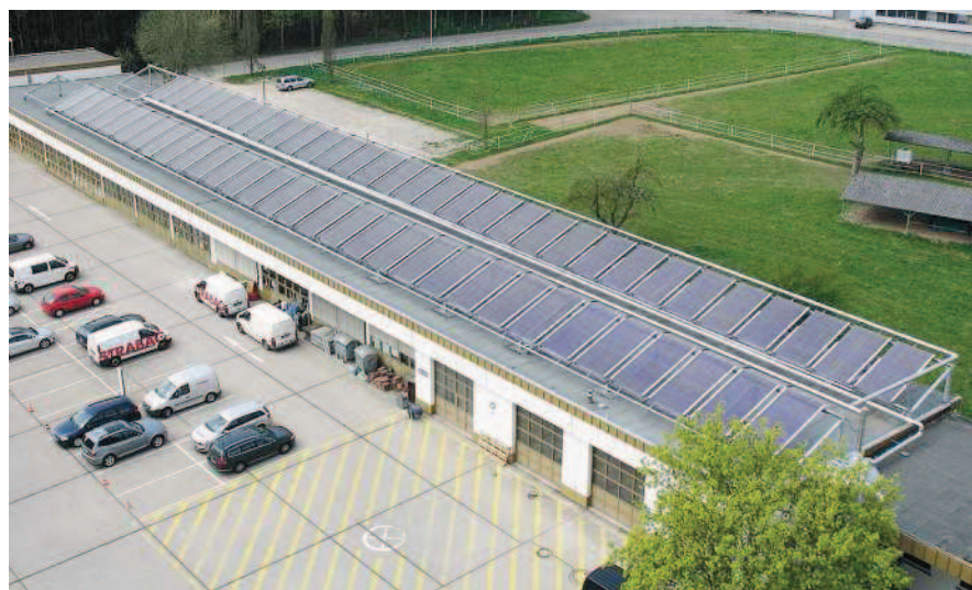
Abb. 3.1-1: Kollektorfeld der solaren Klimatisierungsanlage Rottweil
