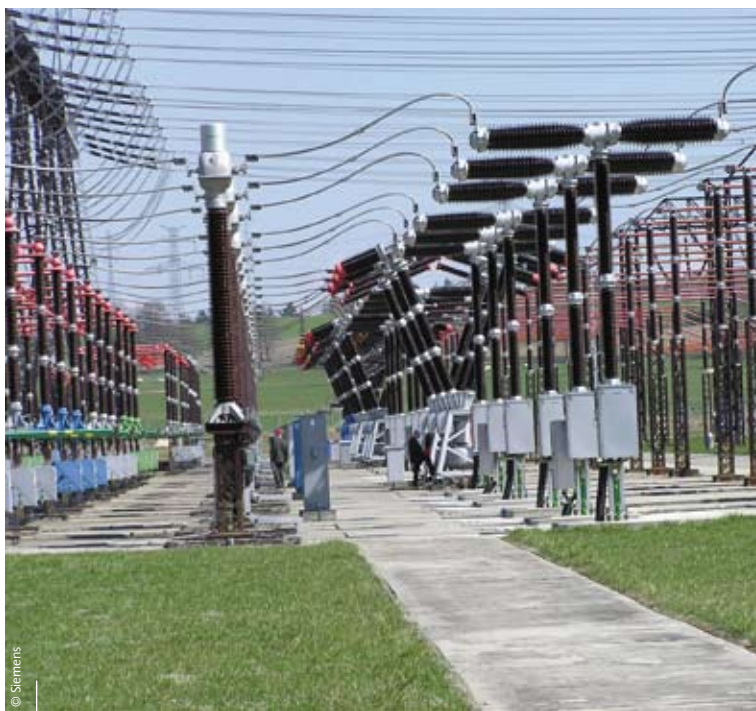
Die OeEB schafft Anreize, in Energieprojekte zu investieren, wie zum Beispiel in die Modernisierung des Verteilernetzes in Georgien.
