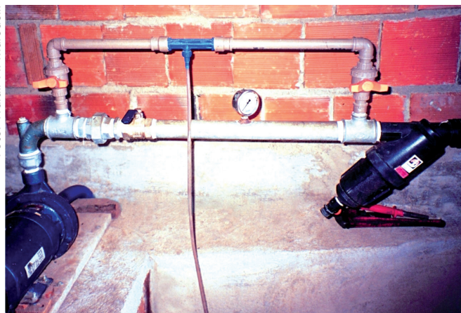
Figura 15. Dispositivo tipo Venturi para injeção de solução fertilizante na tubulação de irrigação, instalado após a motobomba e antes do filtro de água.
