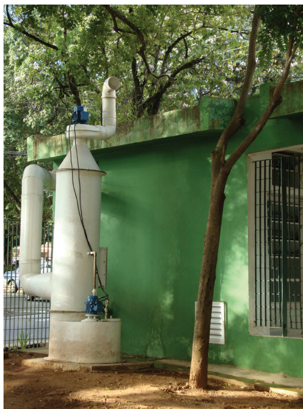
Figura 8. Lavador de gases instalado na capela do Laboratório de Tratamento de Resíduos de Laboratório.
