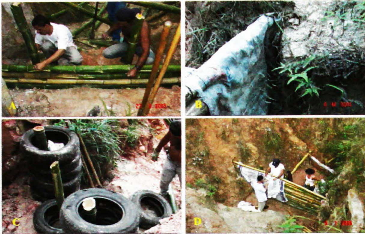
Figura 14: (A) encaixe canaleta no leito da voçoroca e amarrão dos bambus; (B) Detalhe do encaixe dos bambus no barranco lateral; (C) construção de paliçada utilizando pneus usados; (D) colocação de sacos de rafia.
