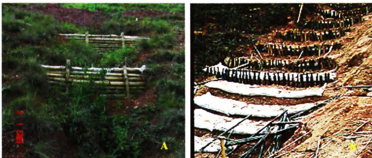
Figura 15: (A) Paliçada de bambu e saco de rafia contendo erosão em sulco, Pinheiral-RJ; (B) controle de erosão estruturas alternativas em encosta localizada em Angra dos Reis-RJ.
