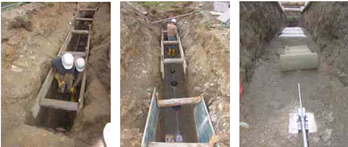
Abb. 4-15: Einbau der Strain-Rosette: (links) Eintreiben der Armierungseisen, (mitte) montierter und ausgerichteter SOFO Sensor, (rechts) Schutz des Sensors beim Zuschütten
