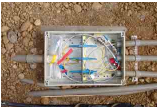
Abb. 4-8: SOFO Kabel und Patchcords in der geöffneten Switch-Box
