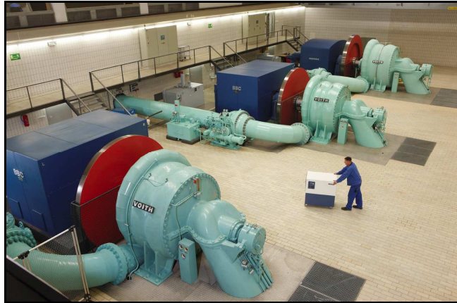
Abbildung 3: Wasserpumpen im Pumpenhaus
