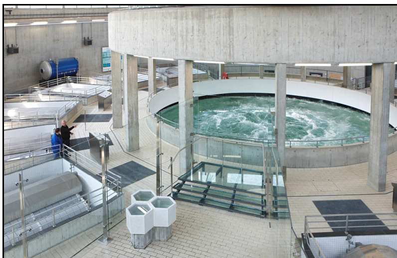
Abbildung 1: Gebäude des Quellbeckens mit kreisförmig angelegten Mikrosieben und dem wabenförmigen Demonstrationsbecken für Werksführungen
