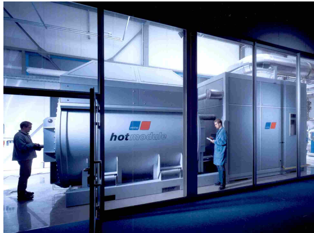
Abbildung 2.3: HotModule am IPF Heizkraftwerk in Magdeburg Copyright: MTU CFC Solutions GmbH
