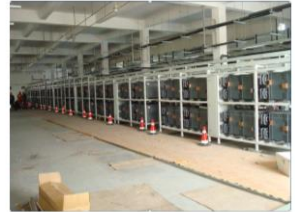
5 MW/10 MWh Rongke
