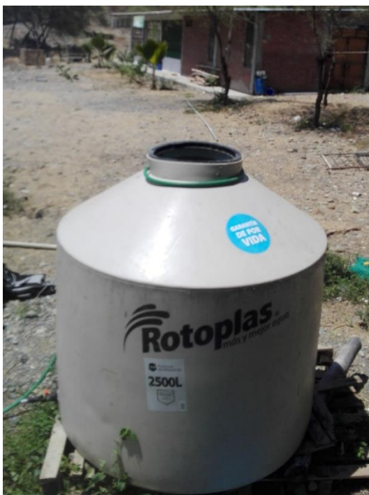
Figura 01: Tanque para el almacenamiento de agua de riego.
