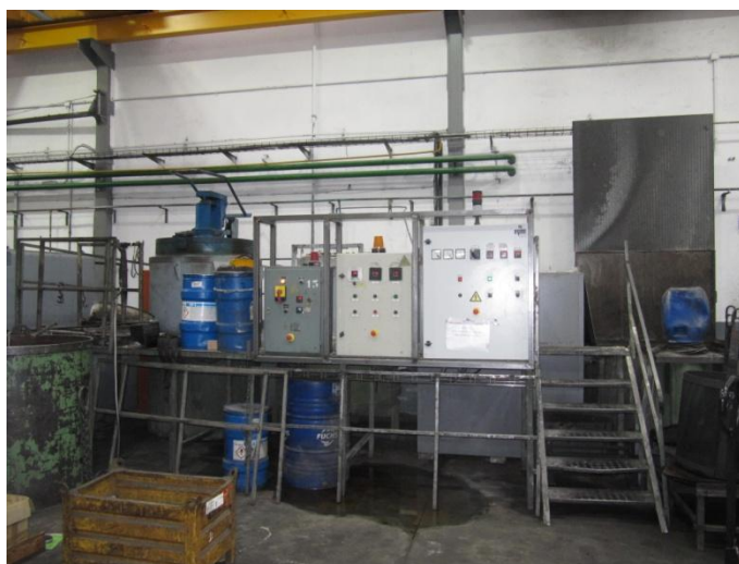
Fig 3.2-7. Vista general de instalación y sistemas de control VTN.
