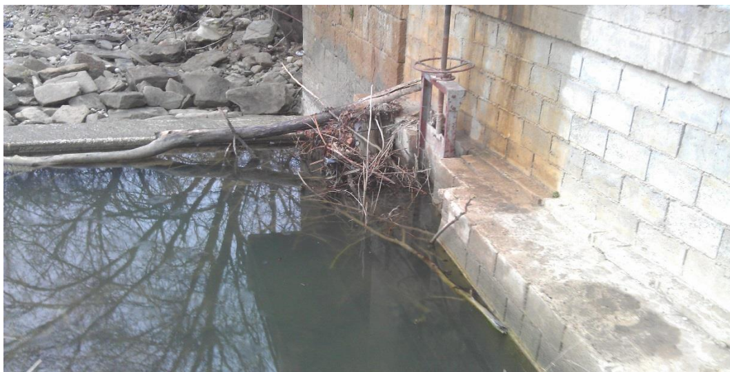
Ilustración 3 Entrada de agua de la instalación
