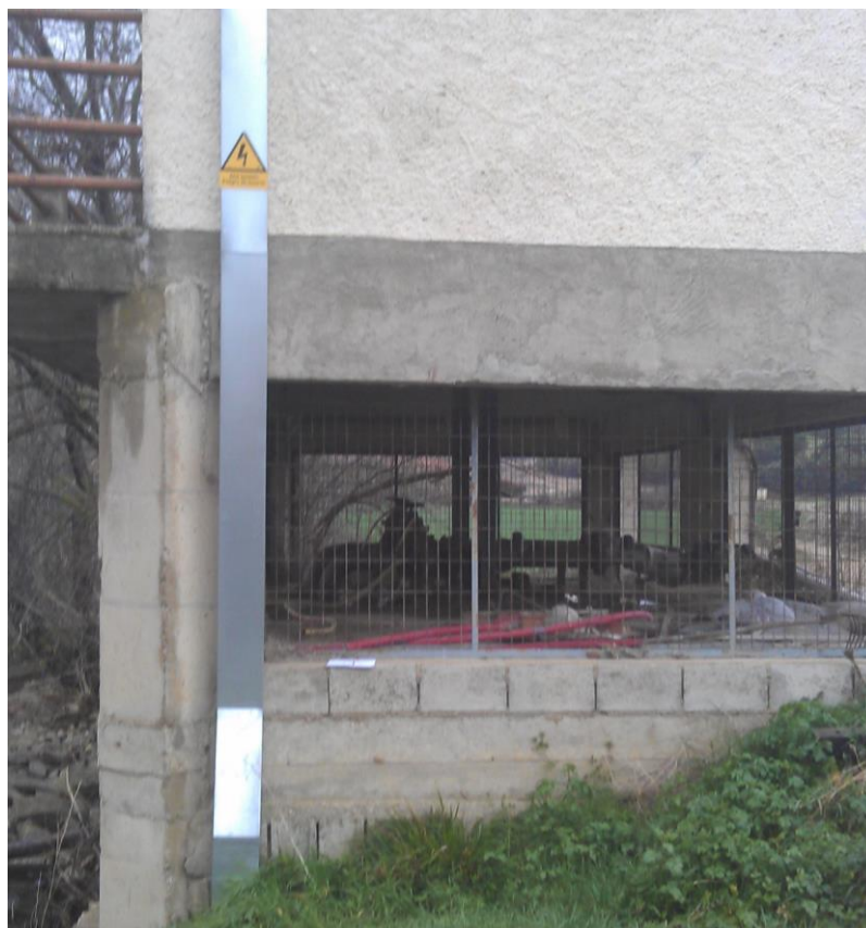
Ilustración 15 Conexión 13,2 Kv hacia el centro de transformación propio
