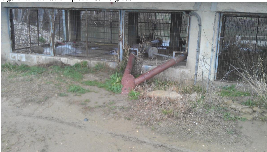
Ilustración 4 Ubicación de las bombas
