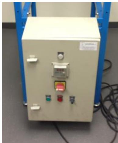
Figura 6.67: foto variador de velocidad
