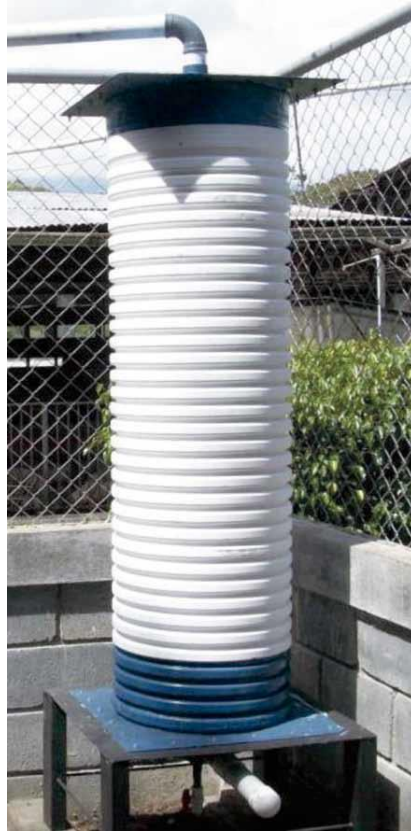
Figura 52: Filtro de remoción de H 2 S. Fuente: VIOGAZ S.A.
