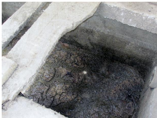
Figura 45: Deposición de sólidos por gravedad en el cuarto de lodos
