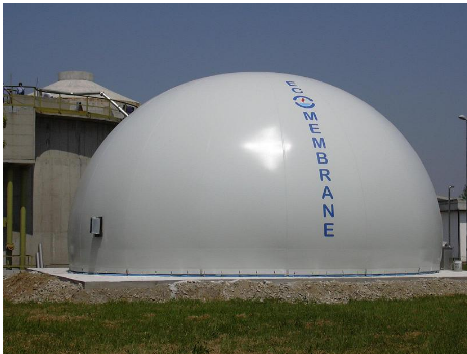
Figura 48: Gasómetro para almacenamiento de biogás. Fuente: Ecomembrane Environmental Technology
