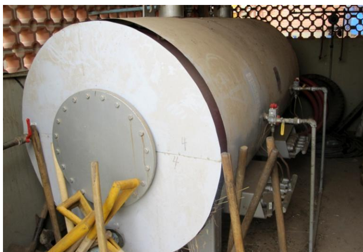
Figura 14: Caldera del matadero municipal de Cochabamba
