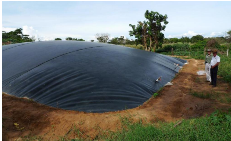
Figura 3: Biodigestor de 1000 m 3 instalado en Santa Cruz (Bolivia). Fuente: J. Martí Herrero
