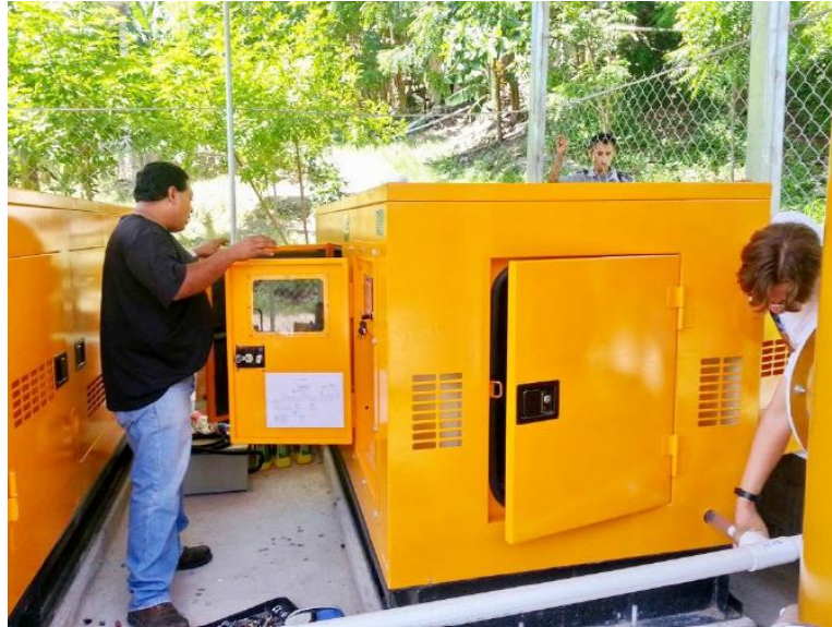
Figura 43: Grupo electrógeno a biogás instalado en una ubicación exterior. Fuente: AQL Engineering
