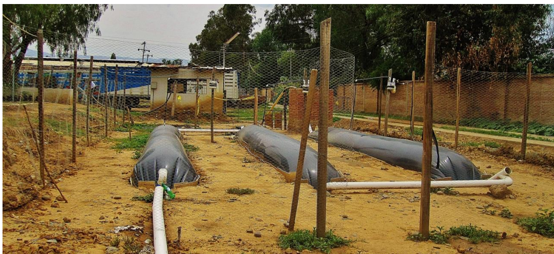
Figura 16: Biodigestores del matadero municipal de Cochabamba
