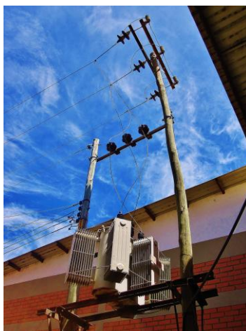
Figura 22: Transformador de 200 kVA del matadero municipal de Cochabamba
