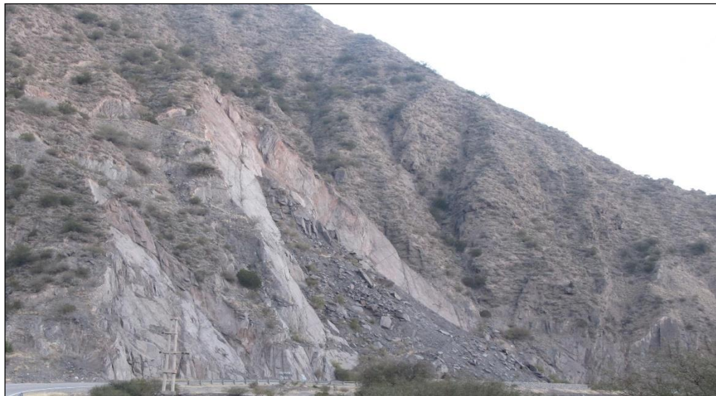
Figura II.4.21: Deslizamiento en cuña en la margen derecha del río Belén.
