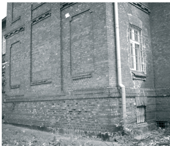
Rys. 2. Widok na S-W część obiektu - ubytki cegieł w ścianie piwnicy spowodowane uszkodzeniami mrozowymi i obecnością soli rozpuszczalnych [6].
