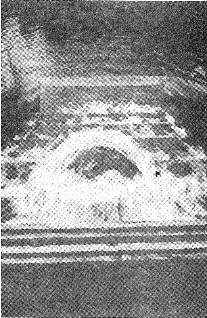
Kuva 5. Kaskadi-ilmastusta Kouvolan Haukkajärven tekopohjavesilaitoksella.
