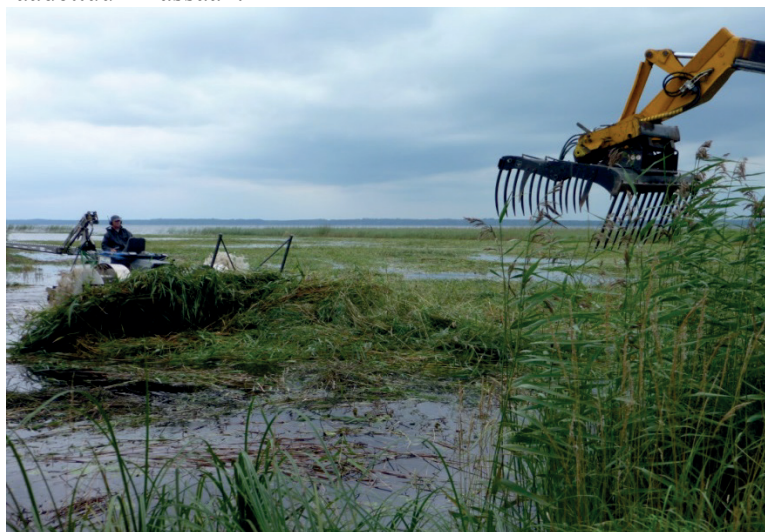
Kuva 28. Vesikasvilauttaa työnnetään kohti odottavaa kurottajaa, joka nostaa tuodun massan kuljettavan traktorin kyytiin Pyhäselän Marjalassa loppukesällä 2013. Kuva: Kaija Saramäki.
