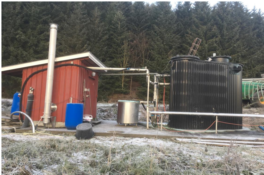
Figur 1. Fra høyre mot venstre: biogass reaktorhus med integrerte varmevekslere, returkum i rustfritt stål, bod for instrumentering og varmtvannskjel.
