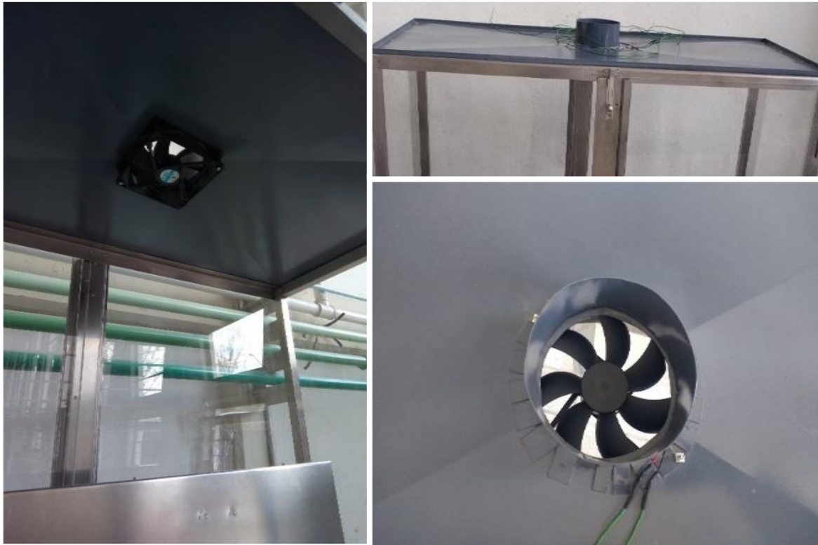
Figura 20. Vista interior, exterior y acercamiento del sistema de ventilación, el cual posteriormente será programado para ser activado en caso de fuga del gas producido durante el proceso de electrólisis
